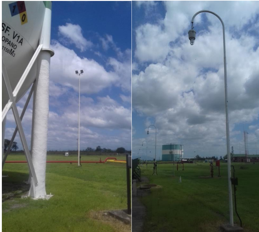
Luminarias LEDs en Planta Leales- Caminería de Esferas
