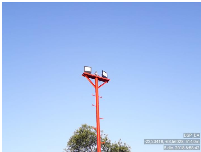
Luminarias LEDs en Portería Campo Durán
